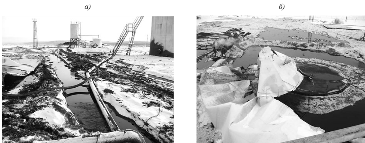
Рис. 1. Последствия аварии резервуара марки РВС-700 в результате хрупкого разрушения основного металла (б – вид сверху)
