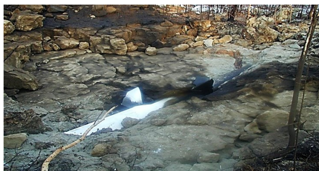
Рис. 4. Общий вид разрушения на 185 км второй нитки магистрального газопровода Берге–Якутск
