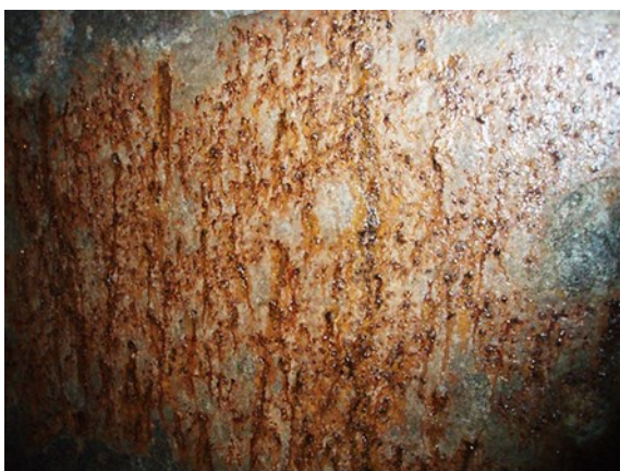
Рис. 1. Точечная коррозия в месте конденсации влаги
